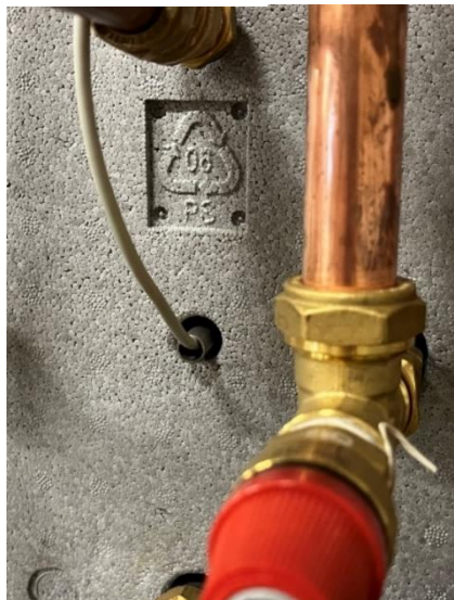
Figuur 13: Zijaanzicht van de accumulator met de temperatuur sensor gemonteerd.
