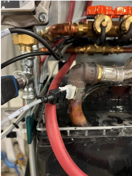
Figuur 33: Inductieblok met temperatuur sensor T2 aangesloten.
