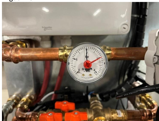
Figuur 29: Manometer van het intern circuit.
