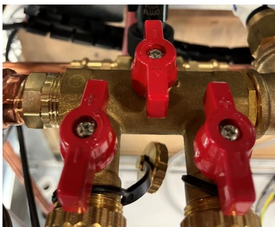
Figuur 20: Spoel- en vulkraan aanwezig in het intern circuit.
